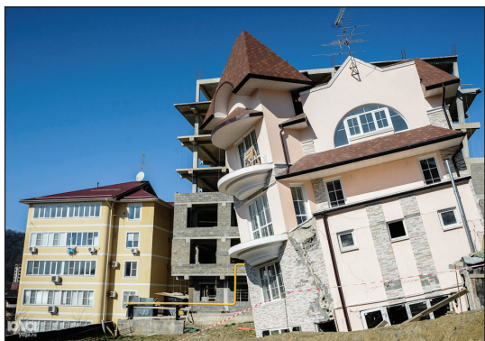
В ходе строительства дублера Курортного проспекта произошло обрушение тоннеля и просел жилой дом фото: Нина ЗОТИНА, ЮГА.ру
